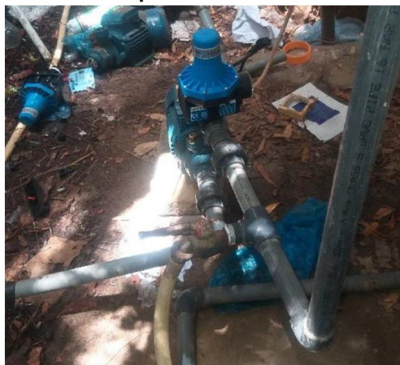
Installation de deux nouveaux surpresseurs d'eau
